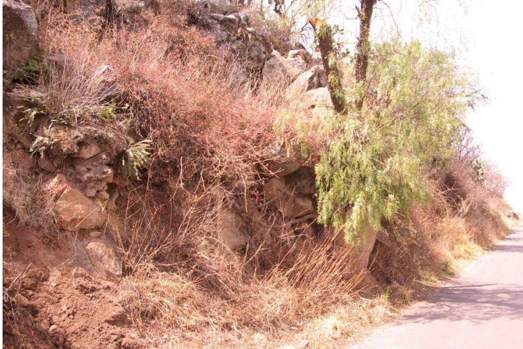
Figura 50. Ladera inestable en la Localidad Neutla, Coroneo. Fuente: (CEPC 2015).
