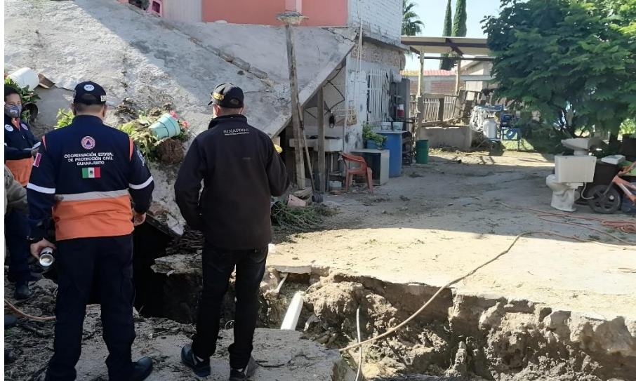
Figura 35. Afectación estructural a vivienda expuesta a agrietamientos y hundimientos diferenciales en el Estado de Guanajuato. Fuente: Gobierno del Estado de Guanajuato.
