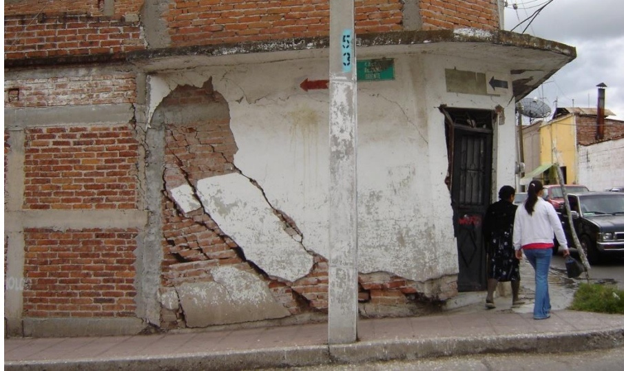
Figura 36. Vivienda expuesta a agrietamiento y subsidencia diferencial en el Estado de Guanajuato. Fuente: Gobierno del Estado de Guanajuato.
