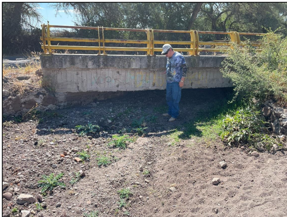
Figura 67. Recorrido de inspección a Zonas de Peligro y Riesgo por Inundación en el arroyo de la Com. San Bartolomé Aguascalientes en el municipio de Apaseo el Alto, Gto. Fuente: (CEPC, GTO).
