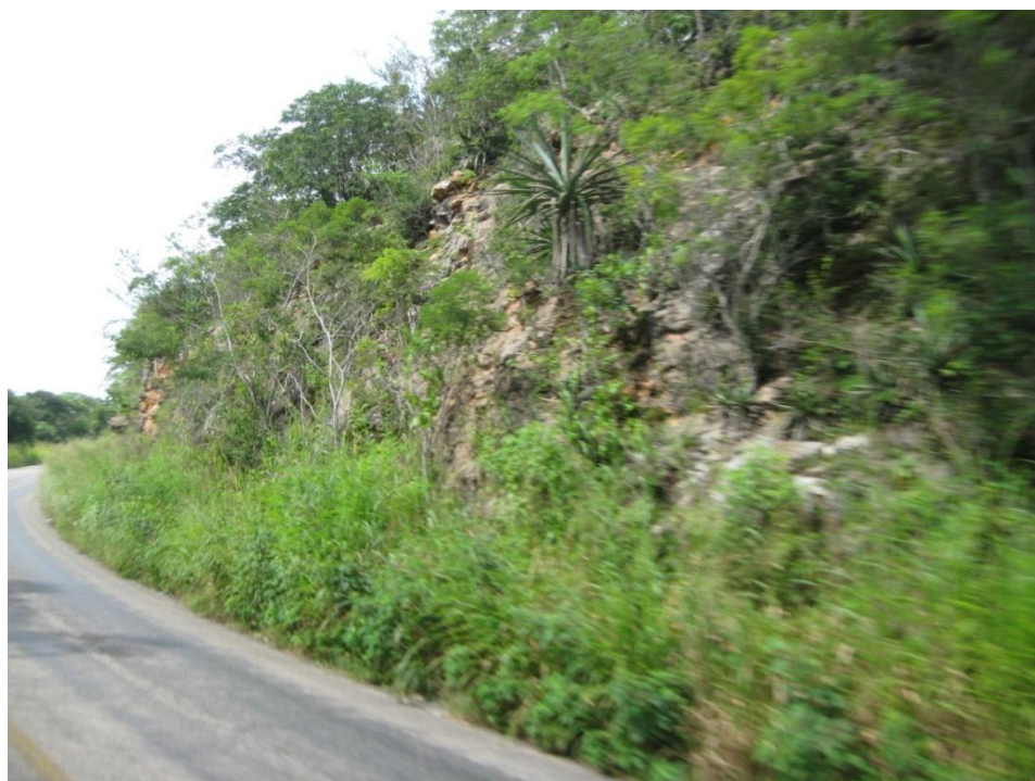
FOTO 13. ZONA DE DERRUMBES CARRETERA TICUL SANTA ELENA.
