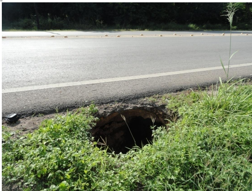
FOTO 18. HUNDIMIENTO EN LA CARRETERA QUE COMUNICA TICUL CON PUSTUNICH
