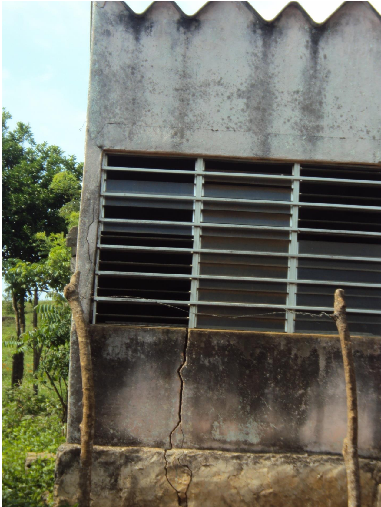
Ilustración 7. Fractura en casa (evidencia sísmica). Municipio de Ángel R. Cabada, Veracruz.
