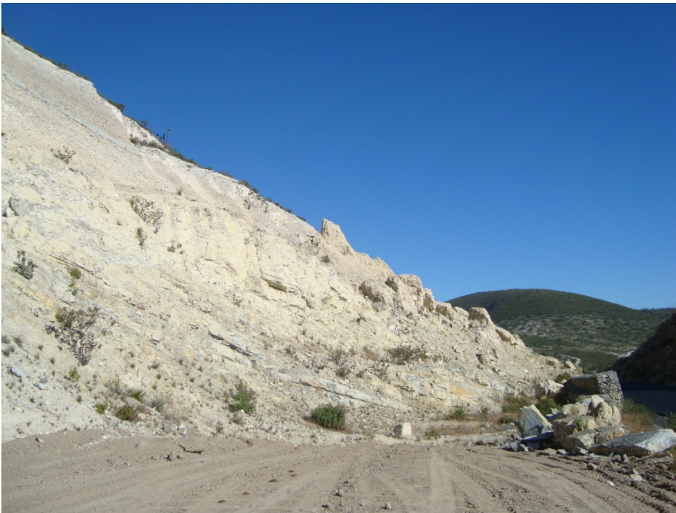
Figura RG-03.- Derrumbe en la autopista México–Orizaba, en el municipio de Cañada Morelos. (reporte fotográfico de campo)
