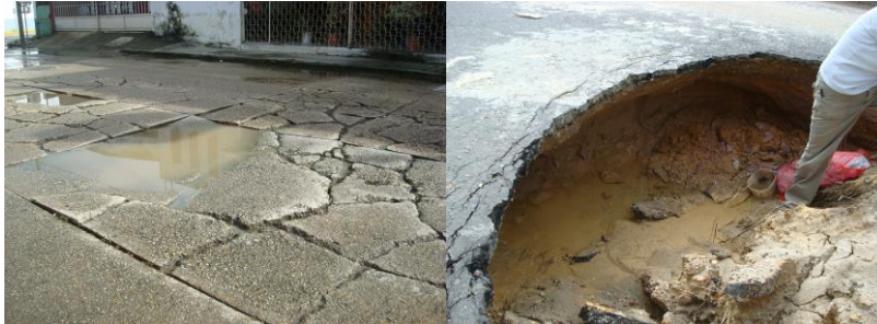
Figura E27. Evidencias de agrietamiento y hundimiento.
