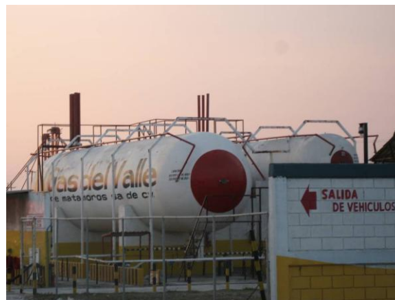
Fotografía 42. Tanques de almacenamiento de Gas del Valle de Matamoros S.A. de C.V. (GAS7001).
