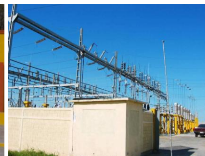
Subestación (CFE5000), Matamoros
