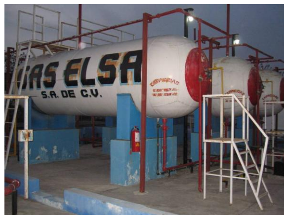
Fotografía 44. Tanques de almacenamiento de Gas Elsa S.A. de C.V. (GAS7002).
