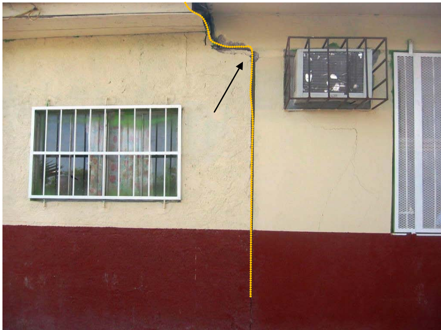
Fotografía 2. Grietas en uniones entre las aulas de la Escuela Secundaria Oficial Profesora María Guadalupe de la Fuente Zertuche.
