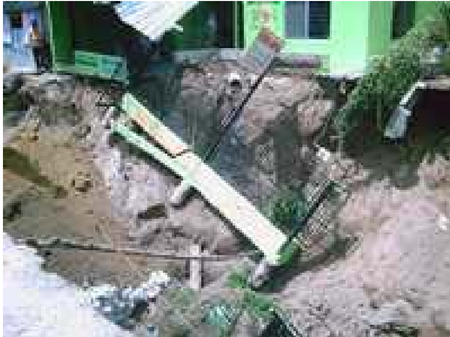
Fotografía 3. Hundimiento en la Colonia Nuevo Laredo. Fuente: La Jornada.
